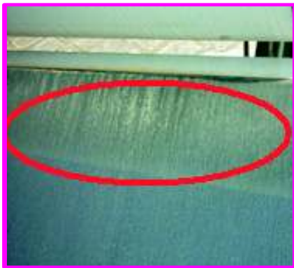
Dépôt de poussières sur le vitrage
