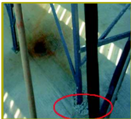
Etanchéité de la toiture terrasse endommagée par le support du CESI
