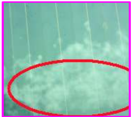
Traces d'humidité sous le verre
