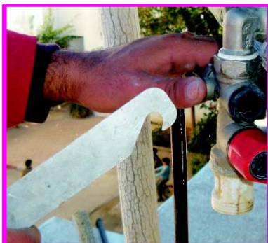
Contrôle et manoeuvre du groupe de sécurité
