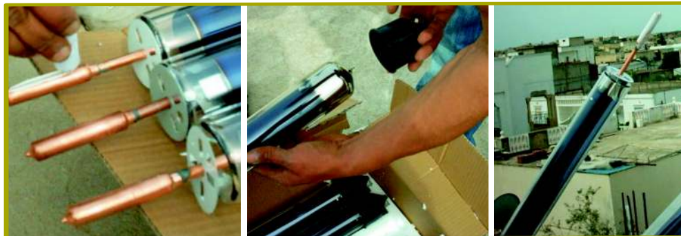
Préparation des tubes sous vide pour montage- application de la pâte thermique et mise en place des capots
