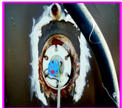
Problèmes de corrosion et d'étanchéité autour de la résistance électrique
