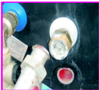
Conduite bouchée par un dépôt de tartre
