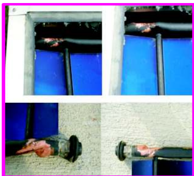
Collecteur tordu suite à un mauvais serrage
